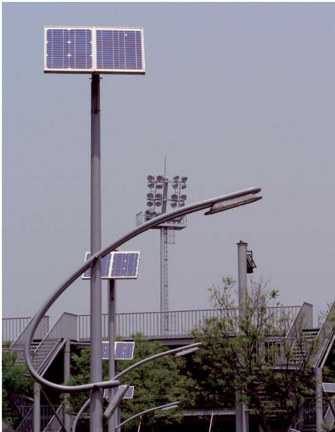
Réverbère surmonté de panneaux photovoltaïques sur le stade de Softball de Fengtai
