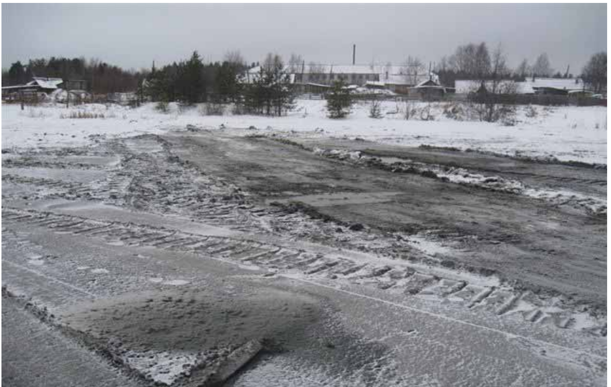
Рис. 3.3.2. Общий вид склада нефтепродуктов (нефтехранилища), расположенного в пос. Покровское Онежского района после завершения планировочных работ.
