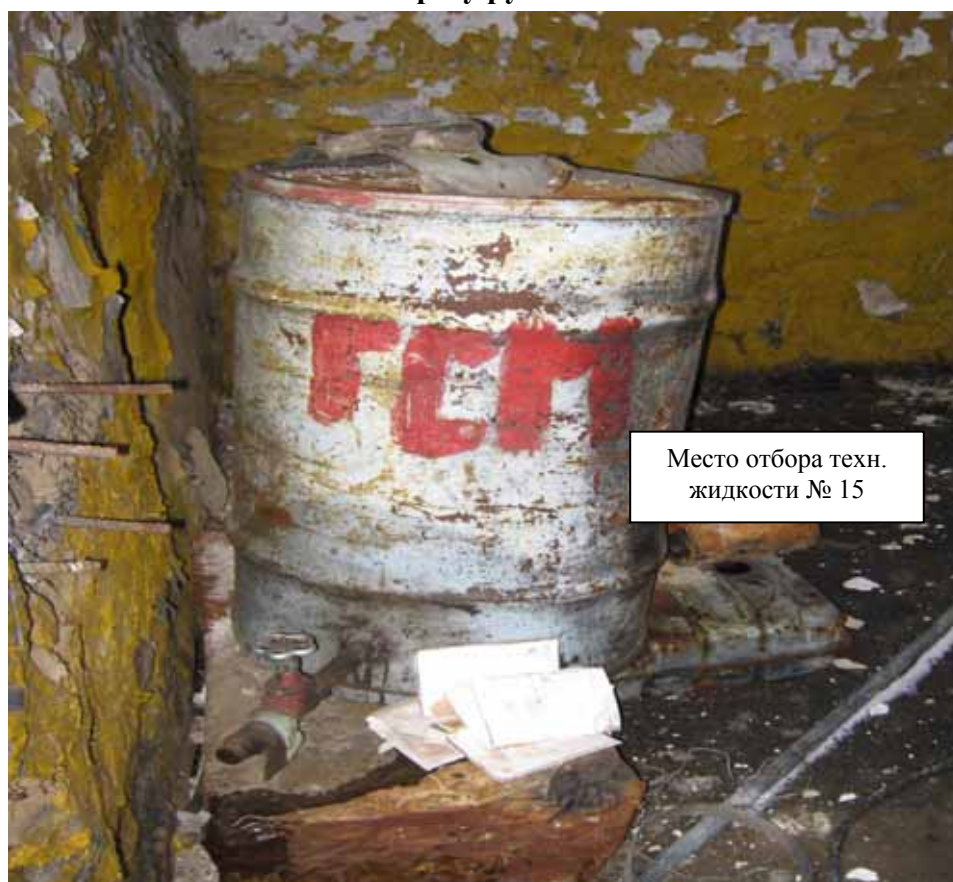
Фото 5.21 Бочка в здании дизельной станции
