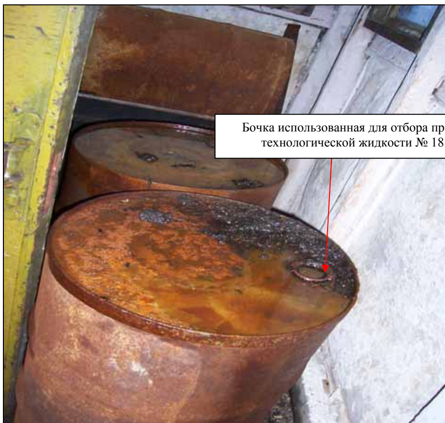
Фото 5.5 Внутри здания дизельной станции
