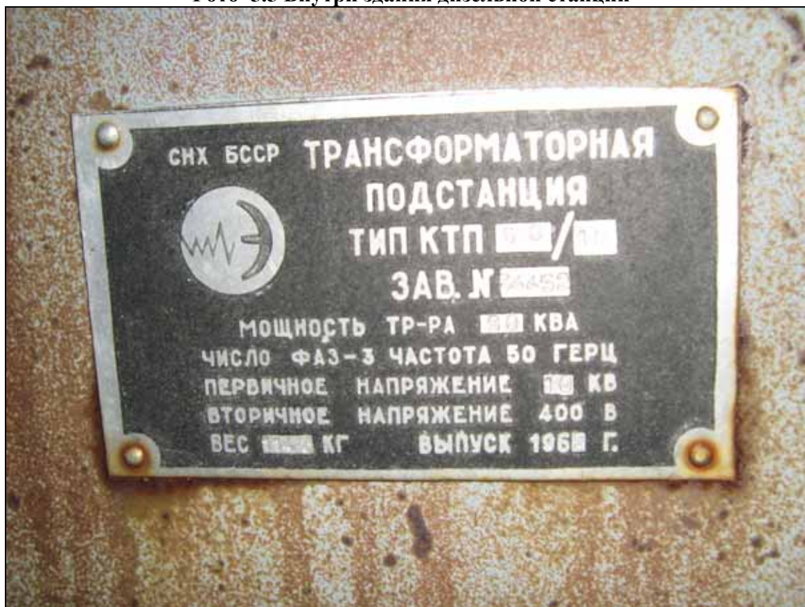
Фото 5.6 Табличка на трансформаторе
