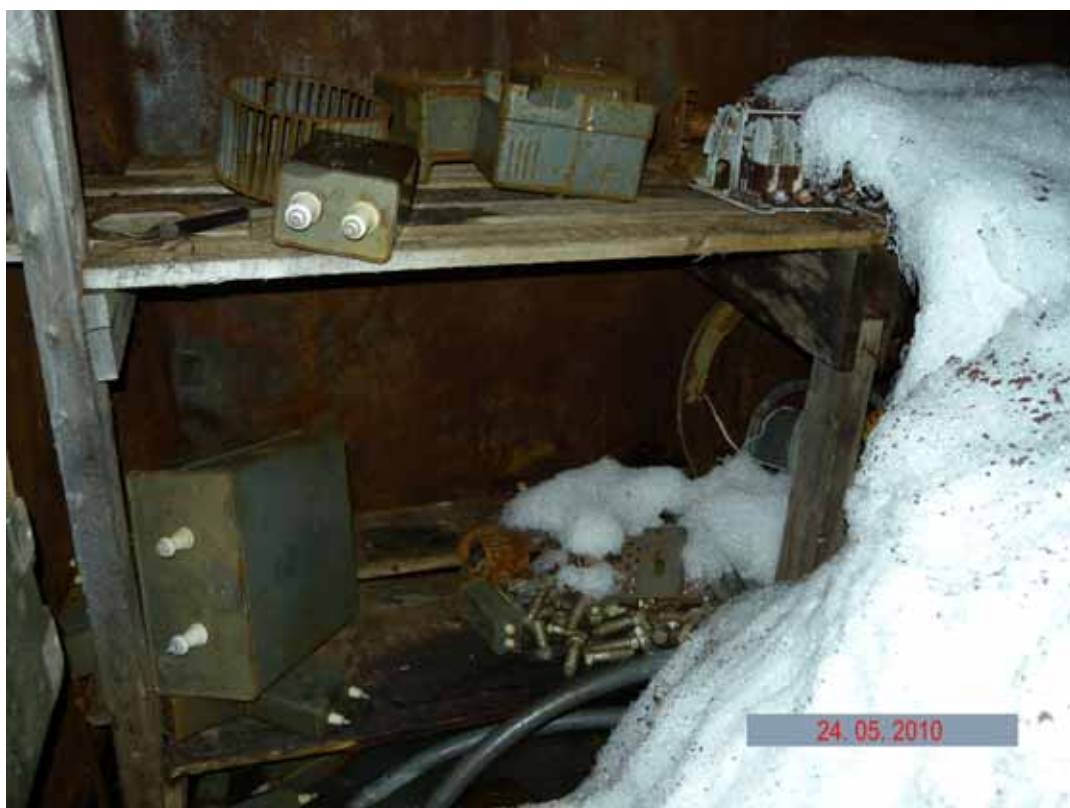
Фото 2.2.32 ПХБ-содержащее оборудование внутри склада конденсаторов и трансформаторов на обследованном участке территории локаторной станции
