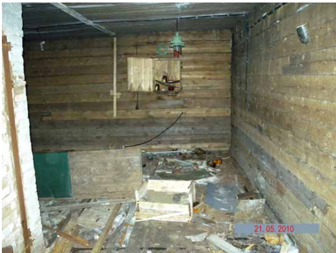
Фото 2.2.18 Помещение внутри здания дизельной с остатками химических реактивов (объект № 280) на территории закрытой полярной станции
