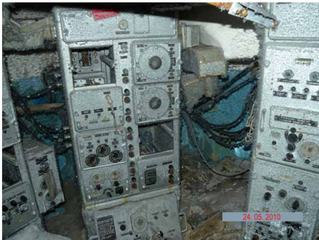
Фото 3.1.8 Аппаратура РЛС в здании РЛС (объект № 169) на обследованном участке территории локаторной станции
