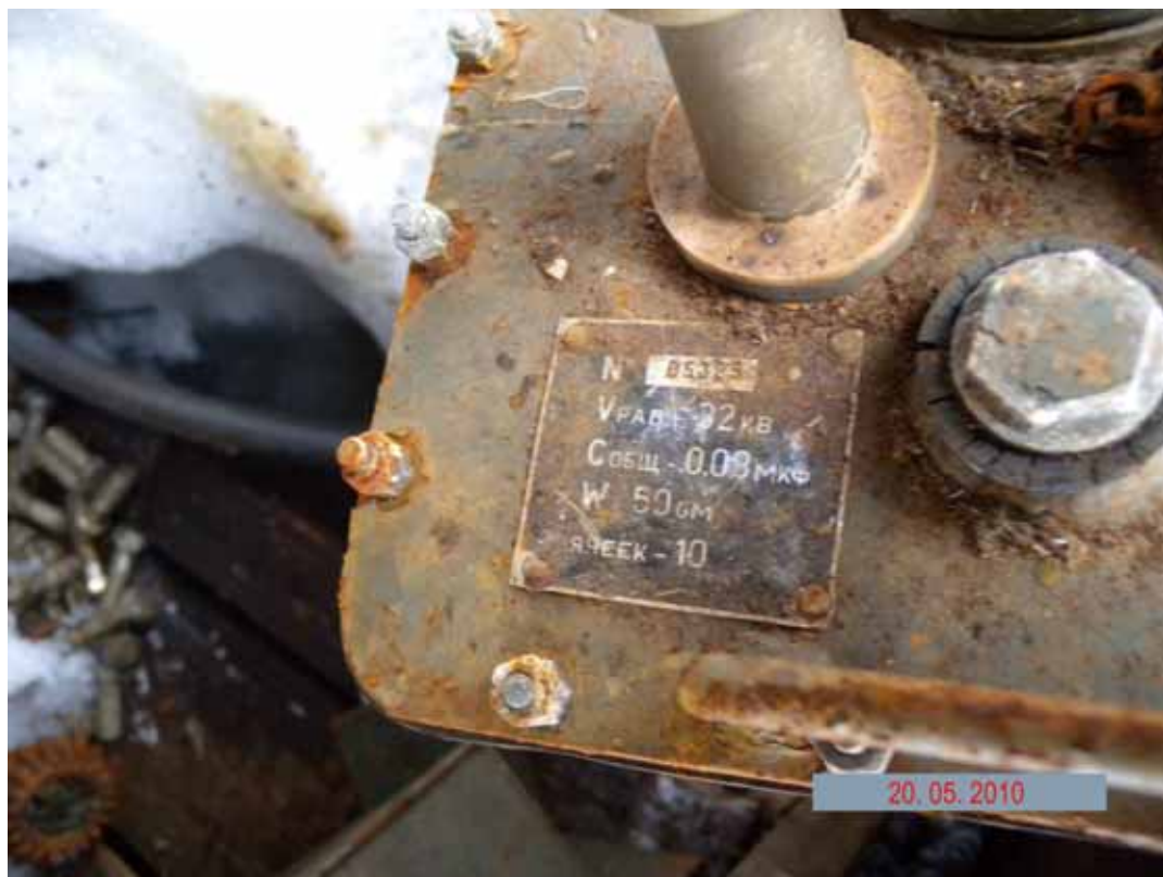
Фото 3.1.2 Высоковольтное оборудование РЛС на складе конденсаторов и трансформаторов (объект № 164) на обследованном участке территории локаторной станции
