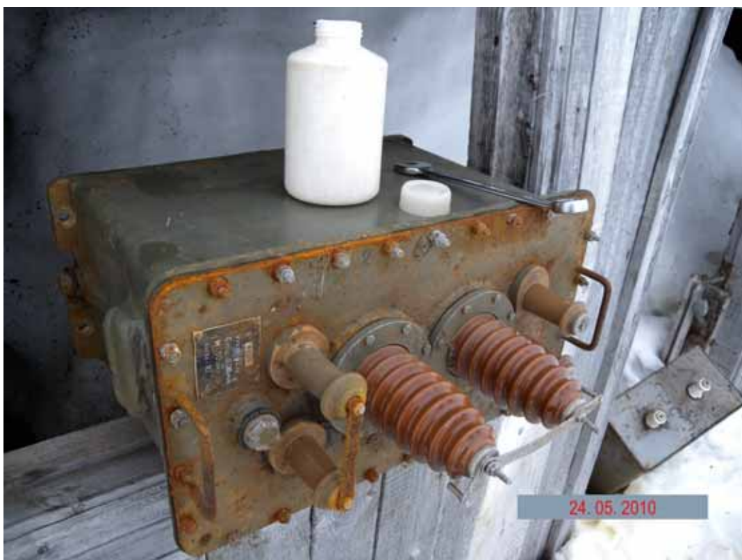
Фото 3.1.5 Высоковольтное оборудование РЭС на складе конденсаторов и трансформаторов (объект № 164) на обследованном участке территории лоаторной станции
