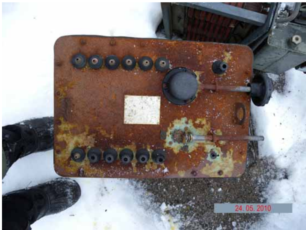
Фото 3.1.12 Высоковольтный трансформатор тока на свалке трансформаторов (объект №330) на обследованном участке территории локаторной станции
