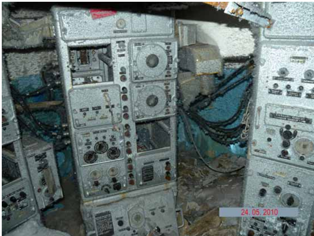
Фото 2.2.35 Оборудование РЛС внутри здания РЛС
