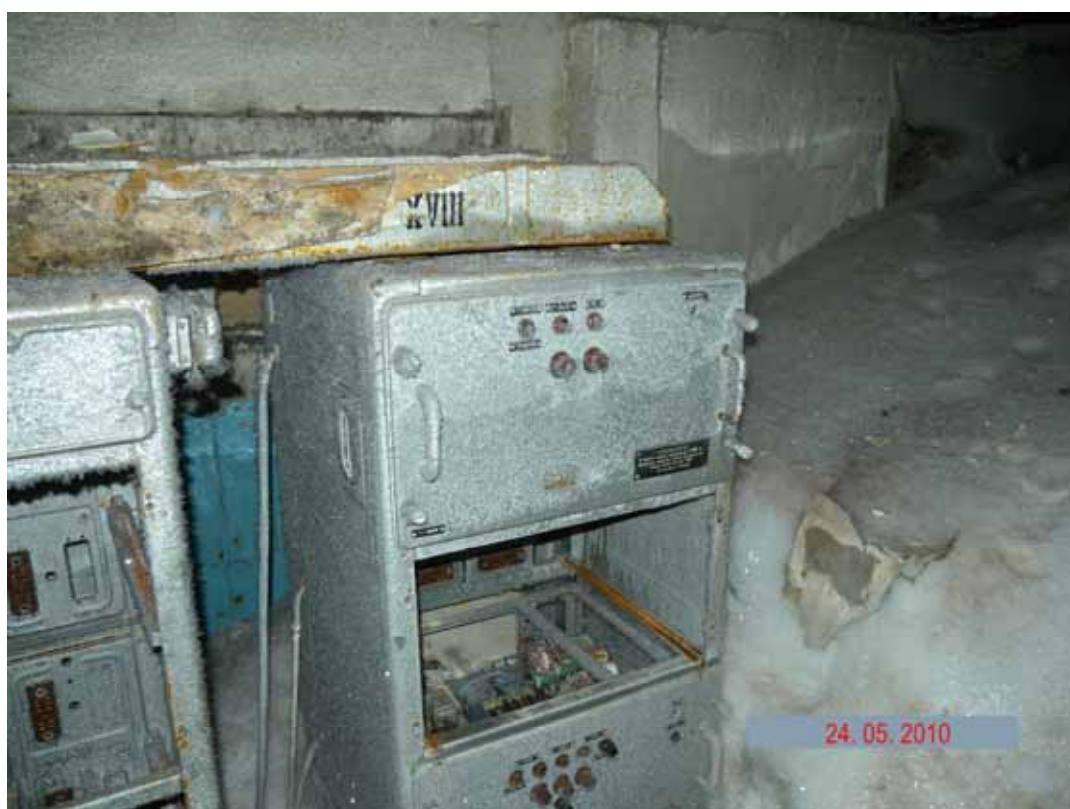
Фото 3.1.7 Аппаратура РЛС в здании РЛС (объект № 169) на обследованном участке территории локаторной станции
