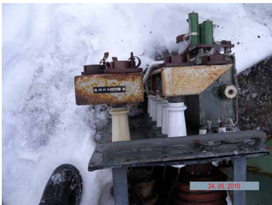
Фото 3.1.13 Высоковольтный трансформатор тока на свалке трансформаторов (объект №330) на обследованном участке территории локаторной станции
