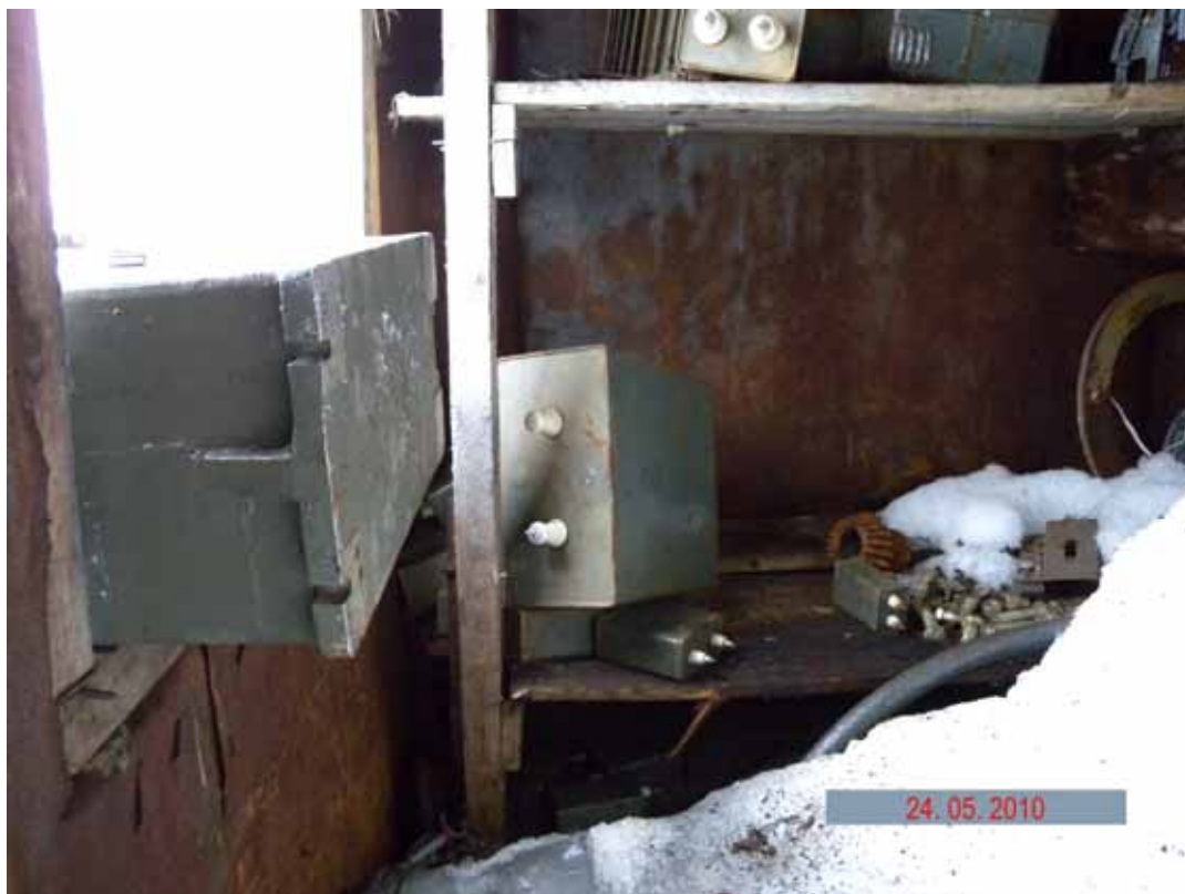
Фото 2.2.31 ПХБ-содержащее оборудование внутри склада конденсаторов и трансформаторов на обследованном участке территории локаторной станции
