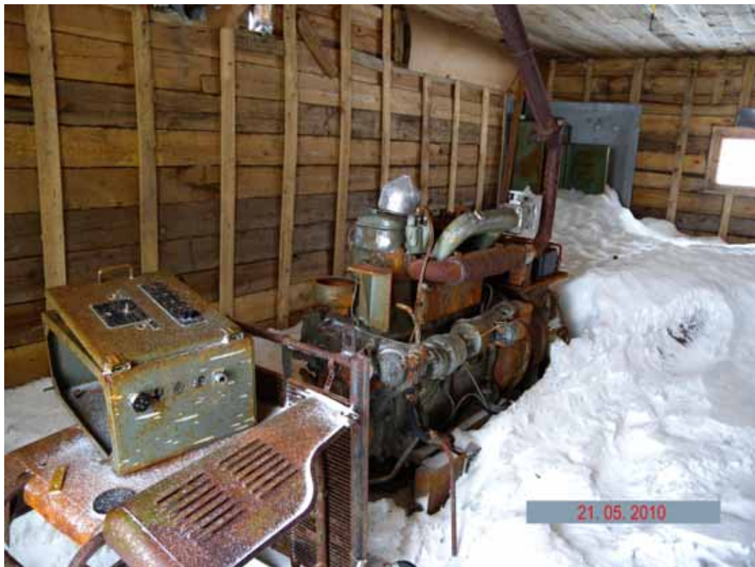
Фото 2.2.17 Помещение дизельгенератора (объект № 280) на территории закрытой полярной станции
