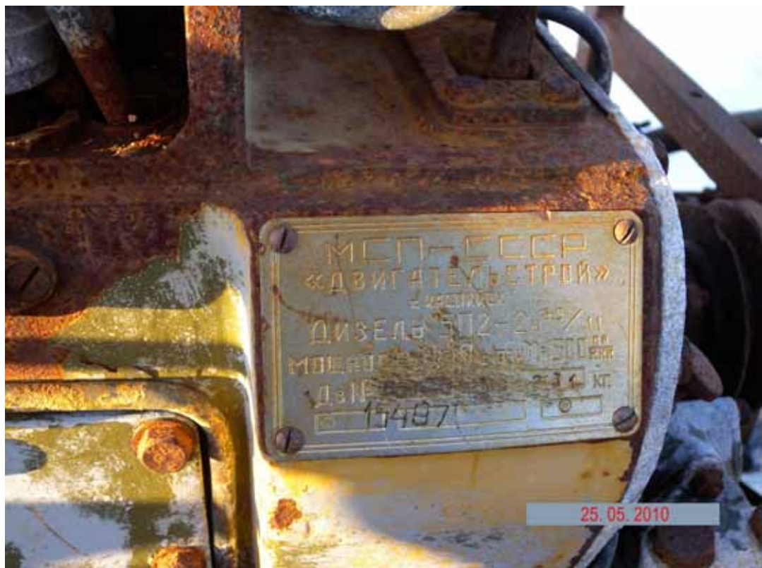
Фото 3.1.15 Дизель-электростанция на свалке оборудования РЛС на обследованном участке территории локаторной станции
