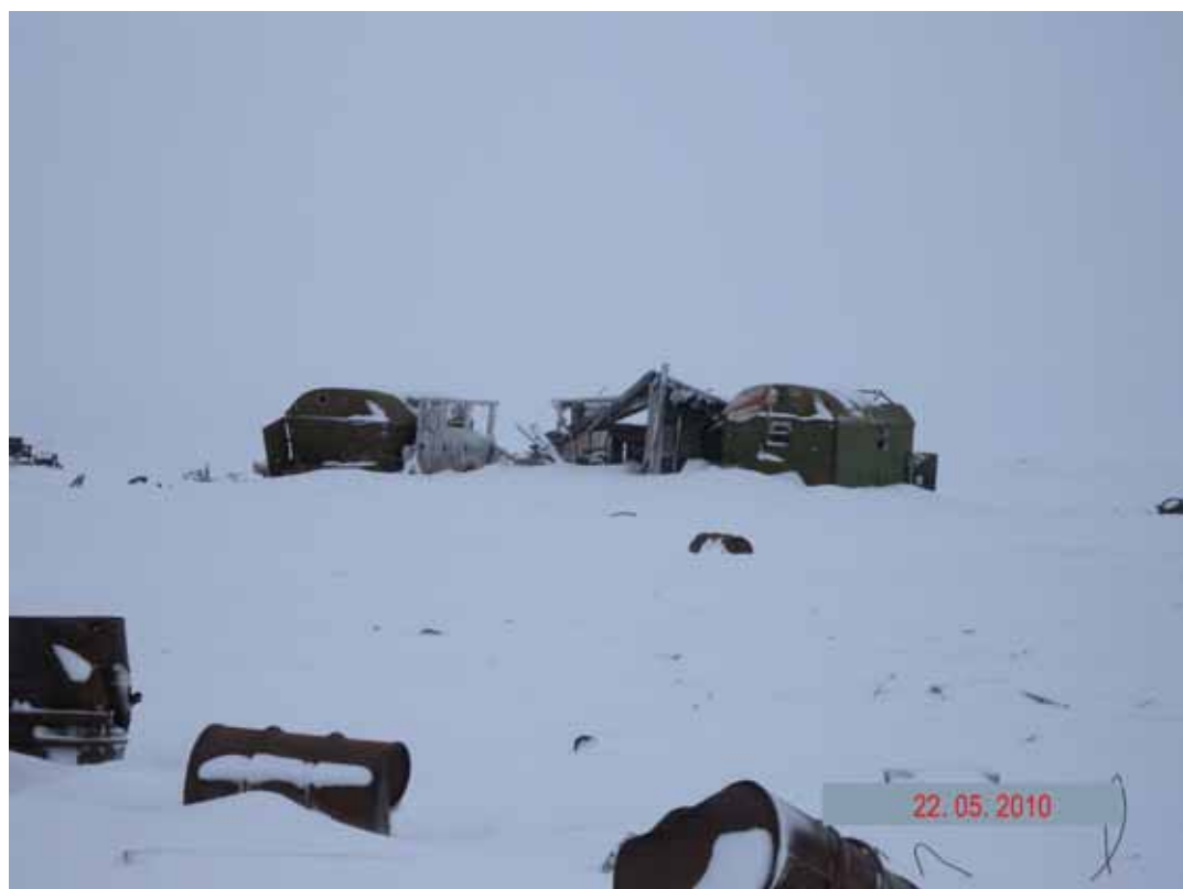
Фото 2.2.26 Разрушенное здание НП комендатуры локаторной станции
