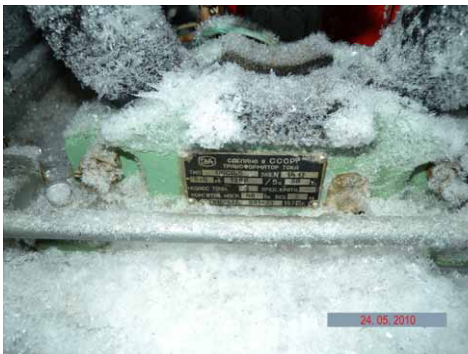
Фото 3.1.11 Высоковольтный трансформатор тока на свалке трансформаторов (объект №330) на обследованном участке территории локаторной станции
