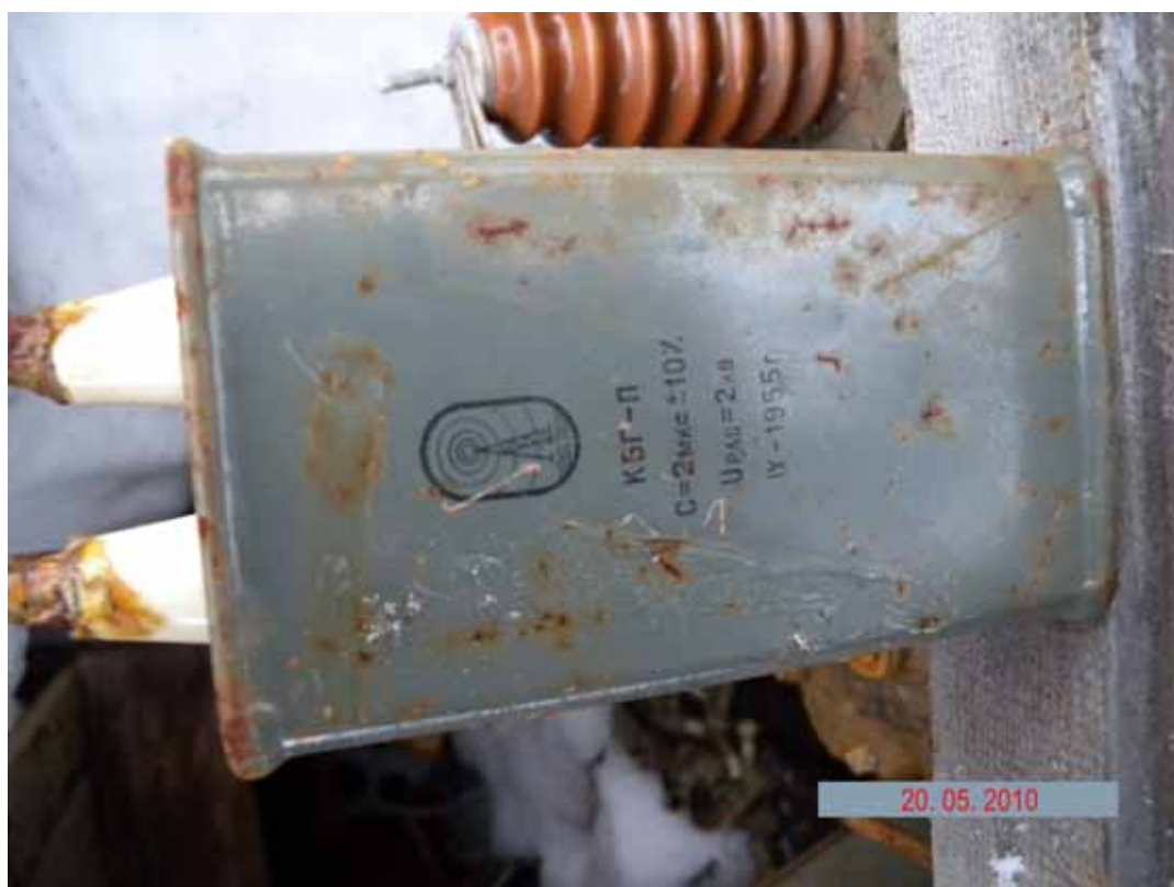
Фото 3.1.3 Высоковольтный конденсатор на складе конденсаторов и трансформаторов (объект № 164) на обследованном участке территории локаторной станции
