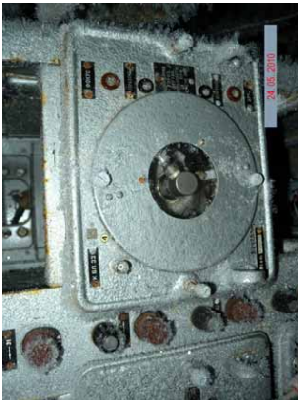
Фото 3.1.10 Аппаратура РЛС в здании РЛС (объект № 169) на обследованном участке территории локаторной станции
