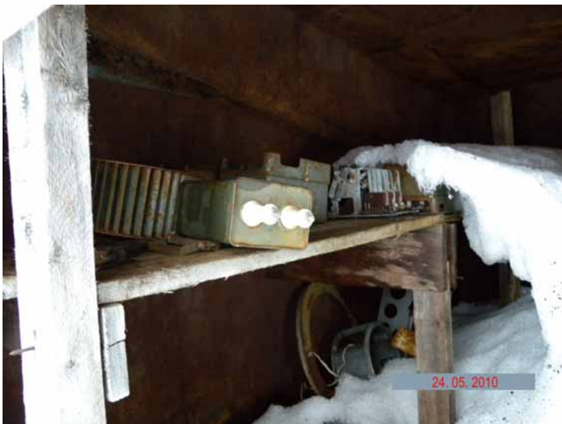
Фото 2.2.30 ПХБ-содержащее оборудование внутри склада конденсаторов и трансформаторов на обследованном участке территории локационной станции
