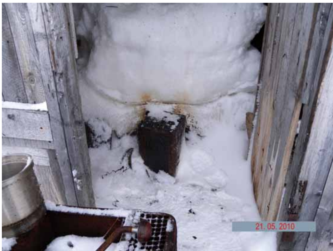
Фото 2.2.16 Емкость с технологической жидкостью в здании дизельной (объект № 280) на территории закрытой полярной станции, отбор пробы № L03-10-18
