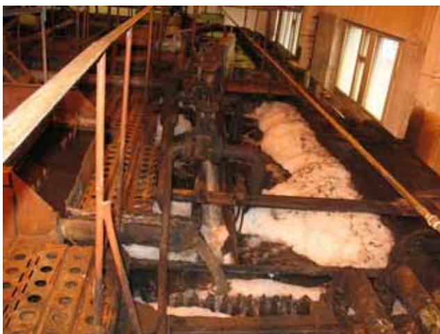
Фото 3. Сооружения биологической очистки КОС пос. Бондарный
