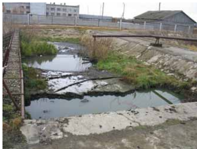
Фото 4. Иловые площадки КОС пос. Бондарный
