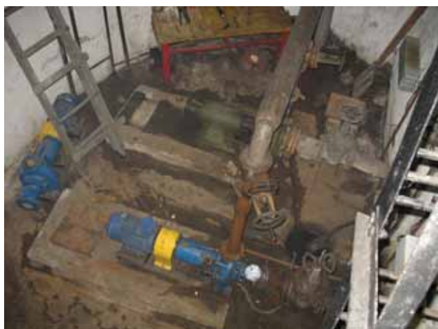
Фото 7. Машинный зал КНС
