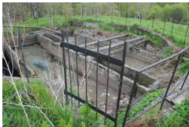
Фото. 2. Двухъярусный отстойник №2, заполненный осадком
