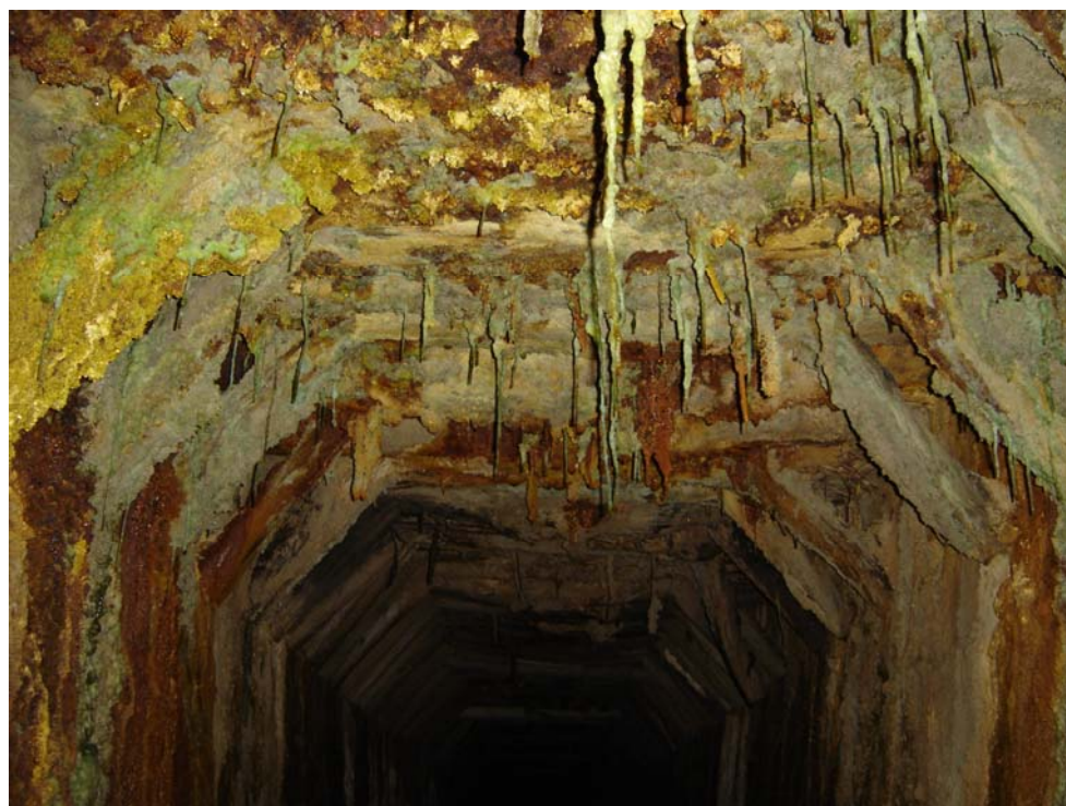
Figura 7 Túnel Tasna Buen Retiro: bóveda reforzada con callapos (Fuente: COMIBOL)
